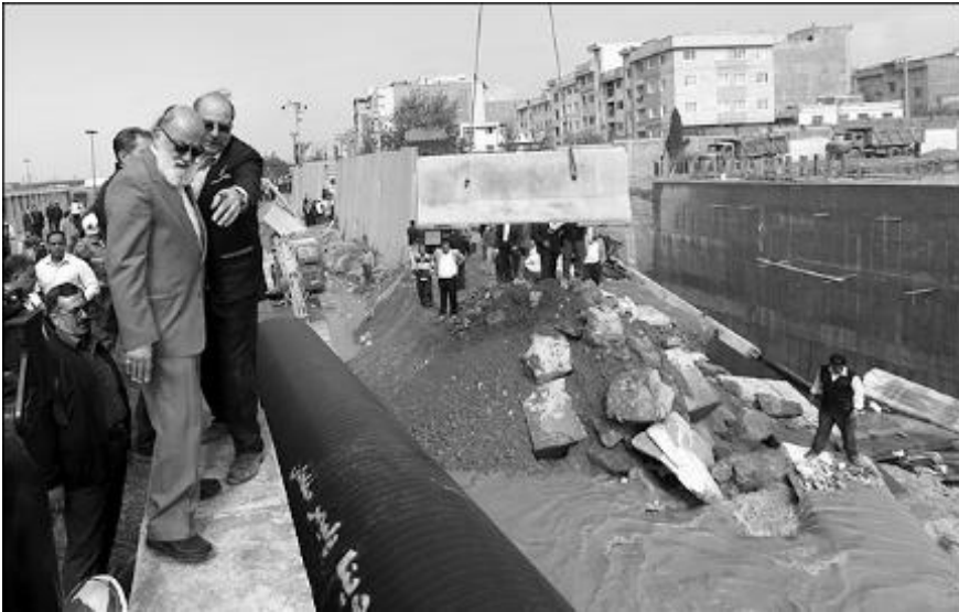
شکل ۲-۲. شکستگی دیواره‌های مسیل و نفوذ آب به درون ایستگاه ارم در خط ۴ (عکس از خبرگزاری مهر).
